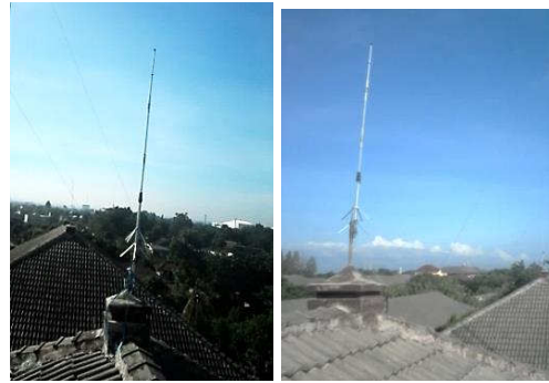
Gambar 12 Antena Terpasang di Gedung B FT-UNRAM
