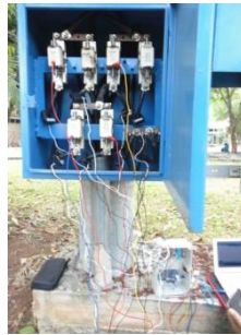
Gambar 3. Rangkaian Pengujian di Transformator Distribusi
