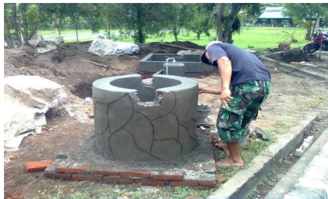
Gambar 4. Pengumpan ( inlet ) digester
