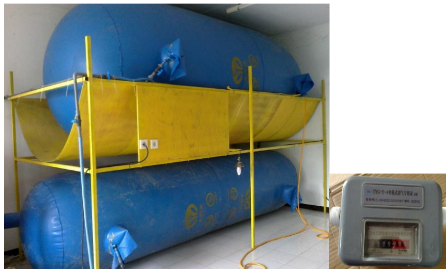
Gambar 6. Penampung biogas 8m 3 dan 6 m 3 serta flowmeter
